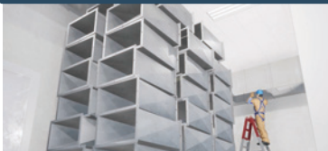
乱雑に積み上げた物は容易に崩れ落ち、 事故となる
